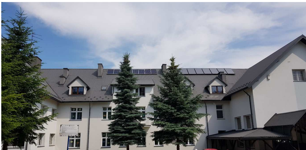
Dach placówki z zamontowanymi ogniwami fotowoltaicznymi oraz systemem solarnym.
